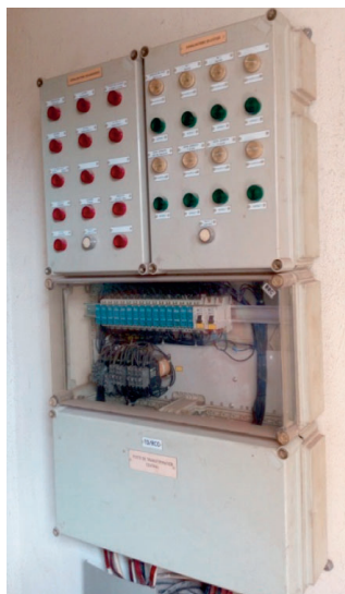
Figure 20 : Armoire Basse tension.
